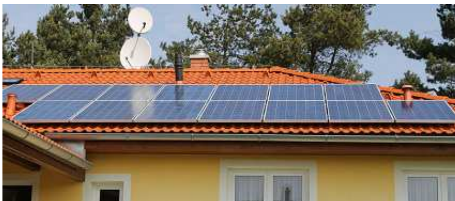
Obr. 13 Umístění fotovoltaických panelů
