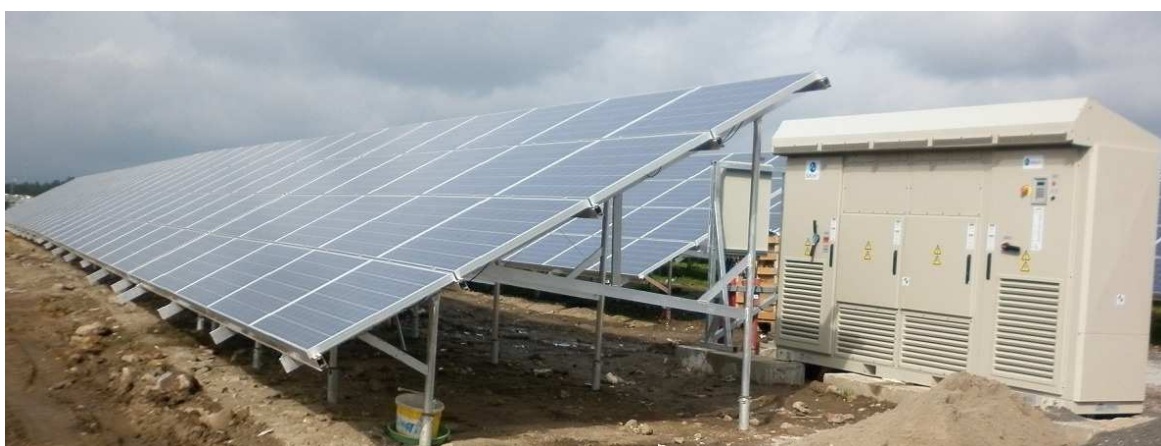
Obr. 20 Umístění FV panelů
