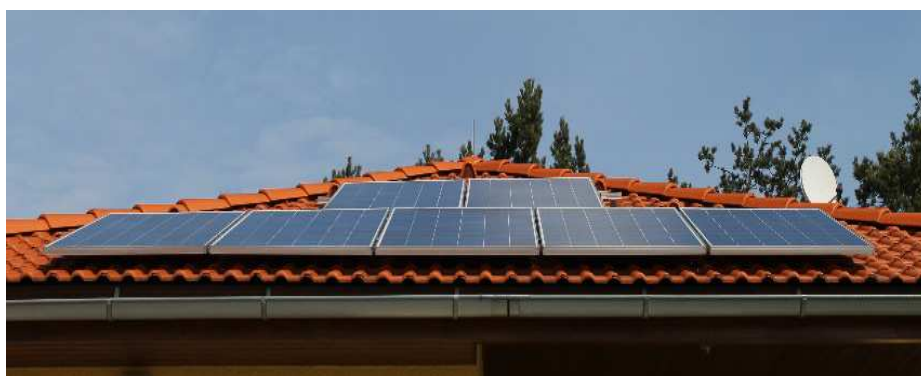
Obr. 14 Umístění fotovoltaických panelů
