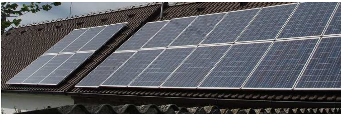
Obr. 18 Umístění fotovoltaických panelů
