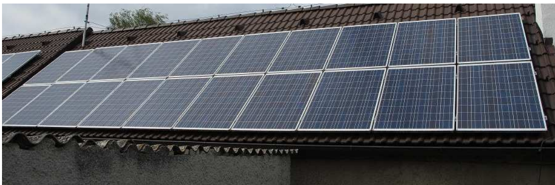
Obr. 17 Umístění fotovoltaických panelů
