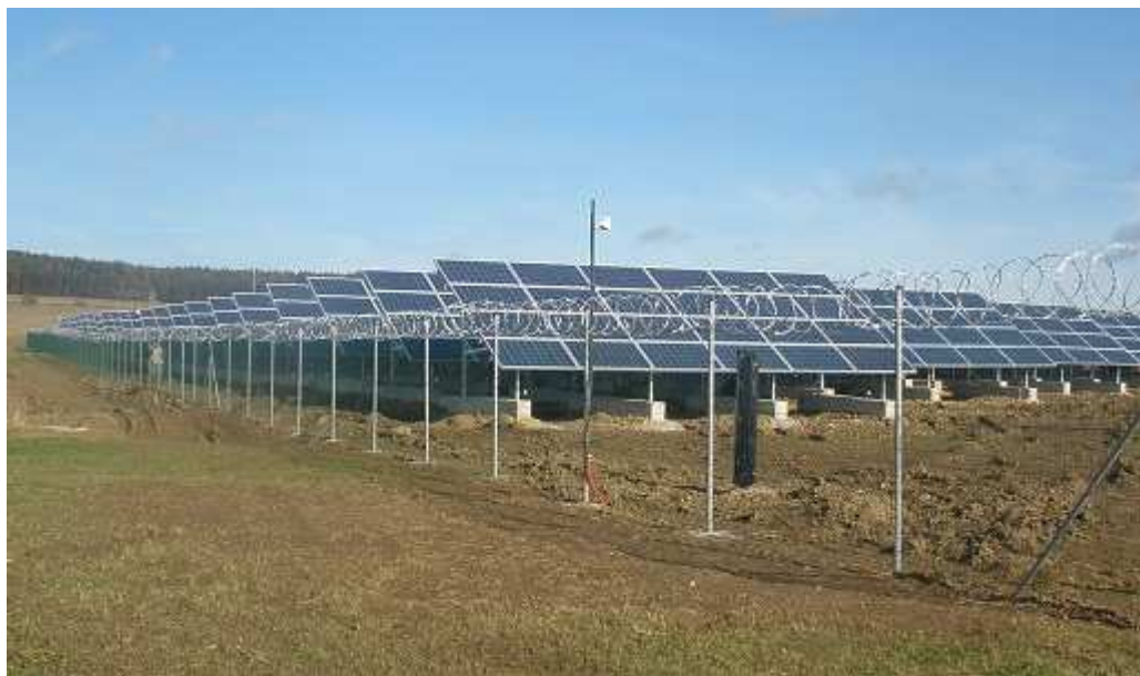
Obr. 22 Umístění FV panelů
