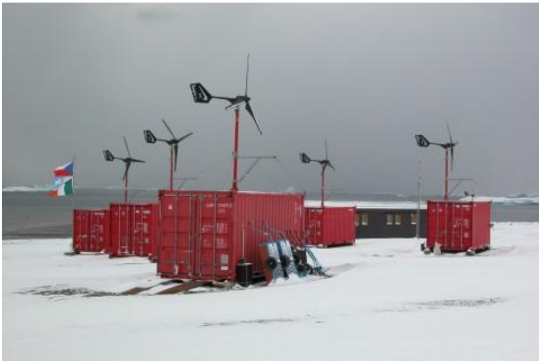
Obrázek 2.2 – Elektrárny zásobující českou polární stanici v Antarktidě
