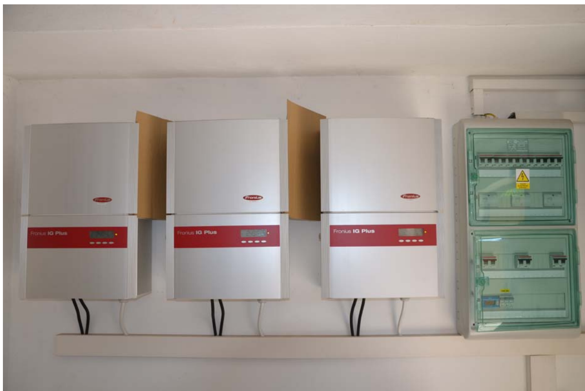
Obr. A.1: Měníče a jističe pro fotovoltaiky
