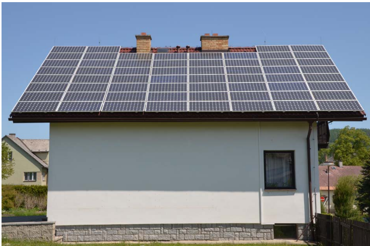
Obr. 6.1: Fotovoltaika na rodinném domě
