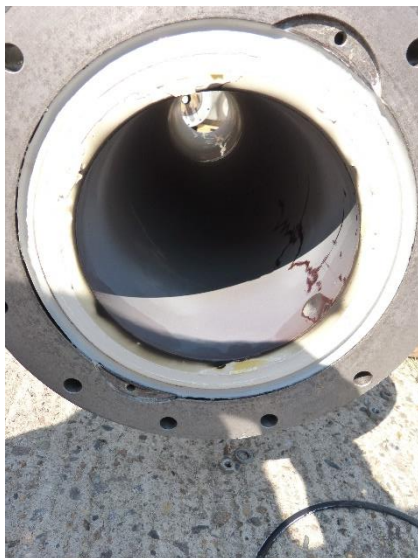
Obr. 2.7 Pohled na komoru vypínače
