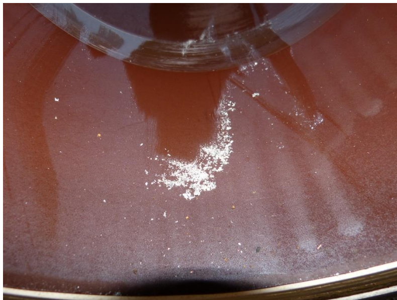
Obr. 2.12 Pohled na komoru vypínače
