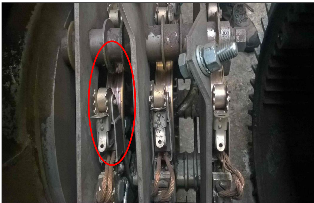
Obr. 2.3 Poškozené kroužky motoru 1K4D 355Y-6
