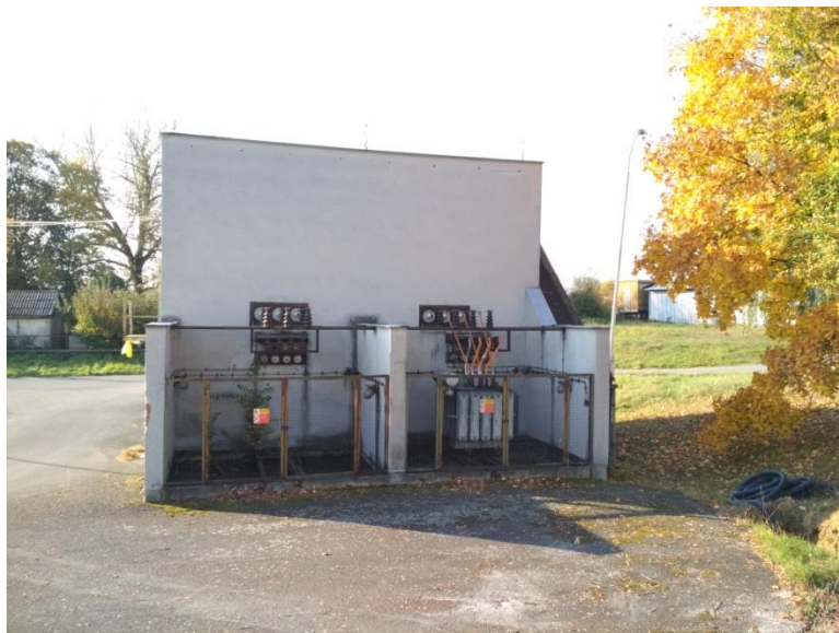
Obr. 2. 4: Transformátorová stanice (Foto: vlastní)
