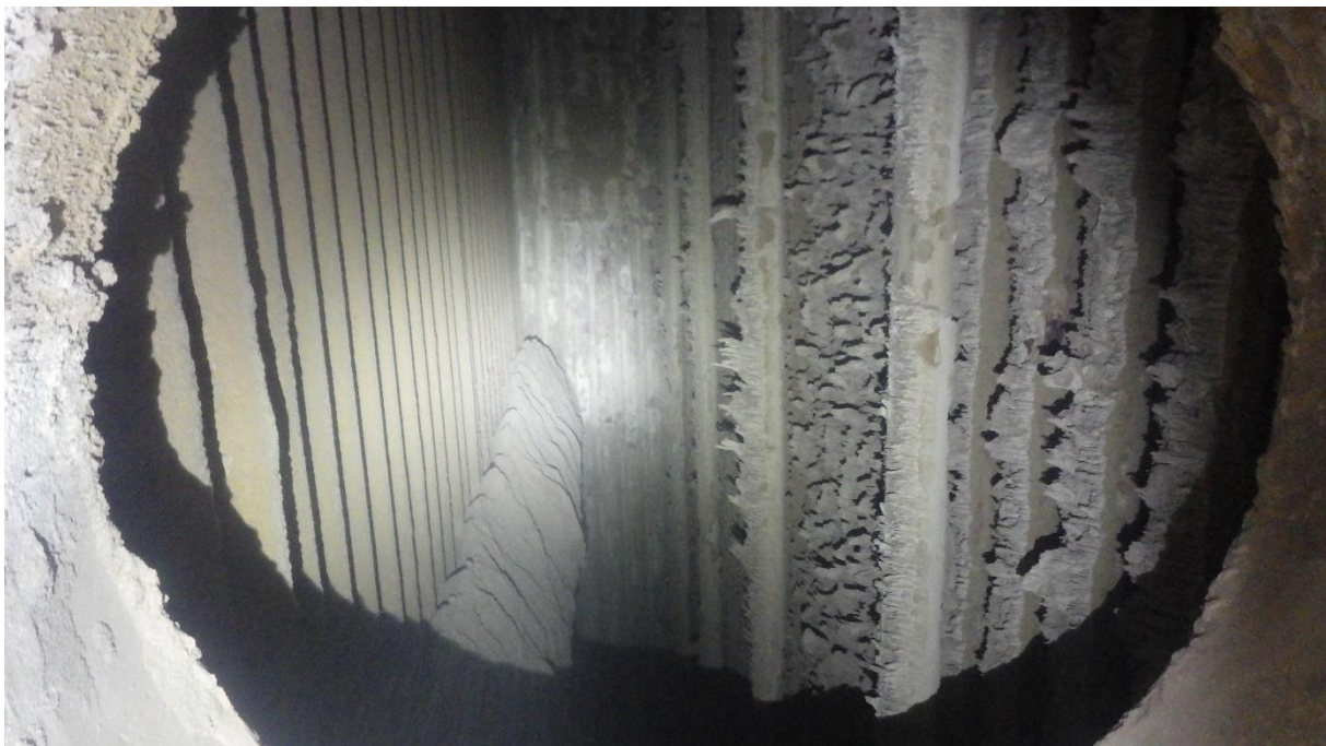
Obr.č. 8: Zanesení výparníkové mříže mezi druhým a třetím tahem kotle.
