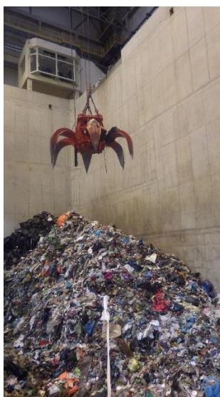
Obr.č.3: Do násypky kotle je komunální odpad přikládán jeřábovým drapákem ze svozového místa KO.
