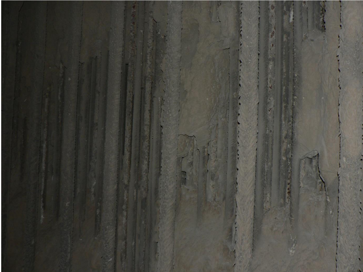
Obr.č. 9: Zneprůchodnění přímé spalinové cesty stmelými nálepy. Přehříváky, čtvrtý tah kotle.
