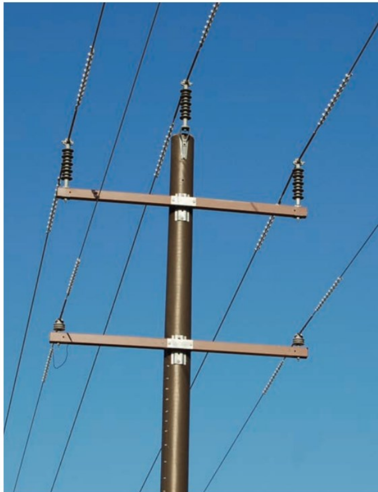
Obr. 2.12: Kompozitní izolační konstrukce VN – převzato [42]
