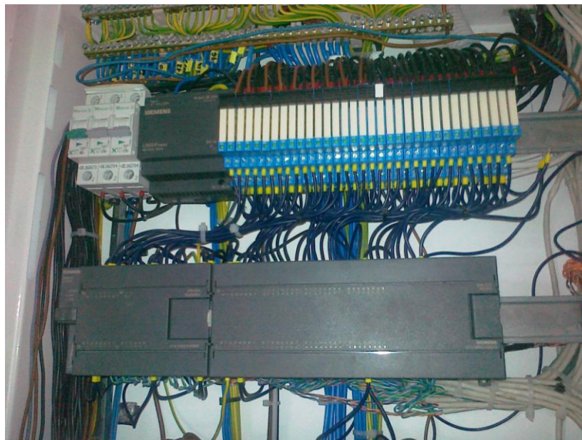
Obr. 4.7 Výsledné zapojení systému SIMATIC v rozvaděči
