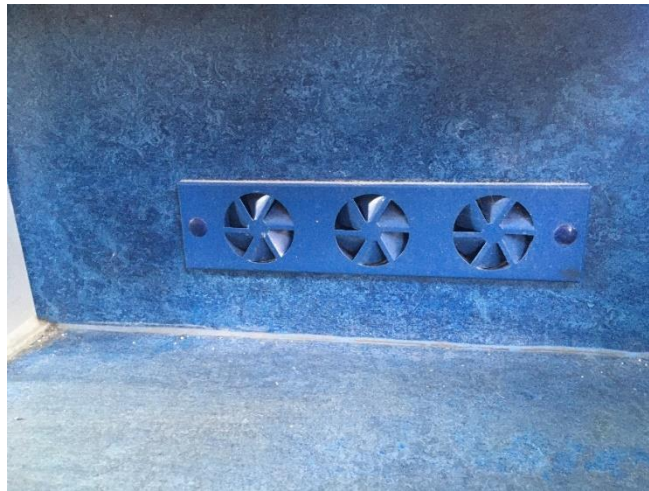
Obr. č. 29 - Výdechy ventilace pod každým sedadlem
