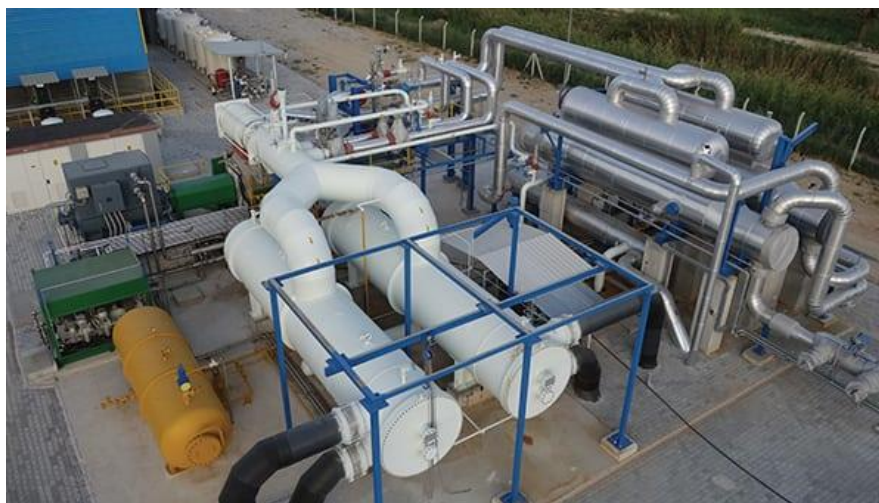
Obrázek 3: Elektrárna Tosunlar v Turecku [5]
