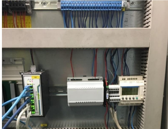
Obr. 5-18 Arduino v rozvodné skříni [zdroj: autor]
