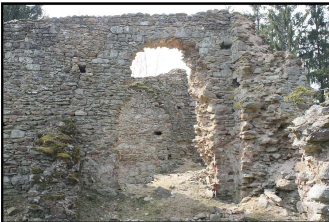
Obr. 29 – Pohled do sakristie, v pravém rohu otisk klenby, dále spárou vymezená plomba nad vylámaným otvorem – foto autor
