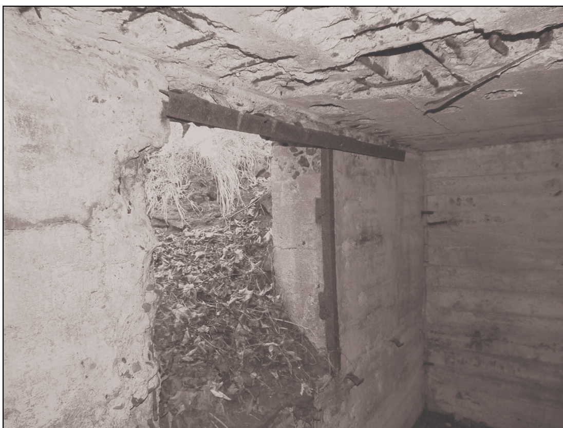
Obr. 7 a 8. Objekt V.a/2/B (poškozená čelní stěna a interiér) Foto S. Bednář.
