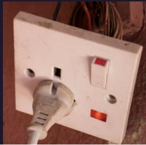
V domě je elektřina.
