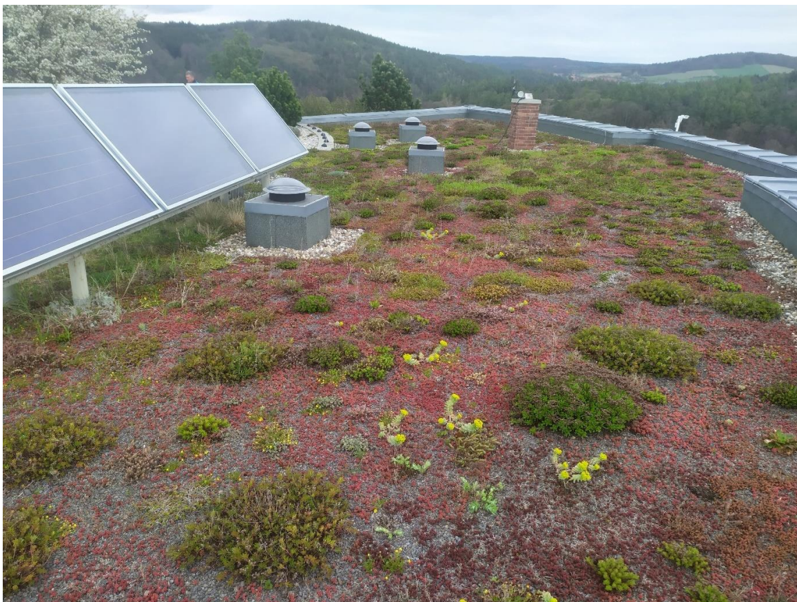
Obr 6. Extenzivní zelená střecha
