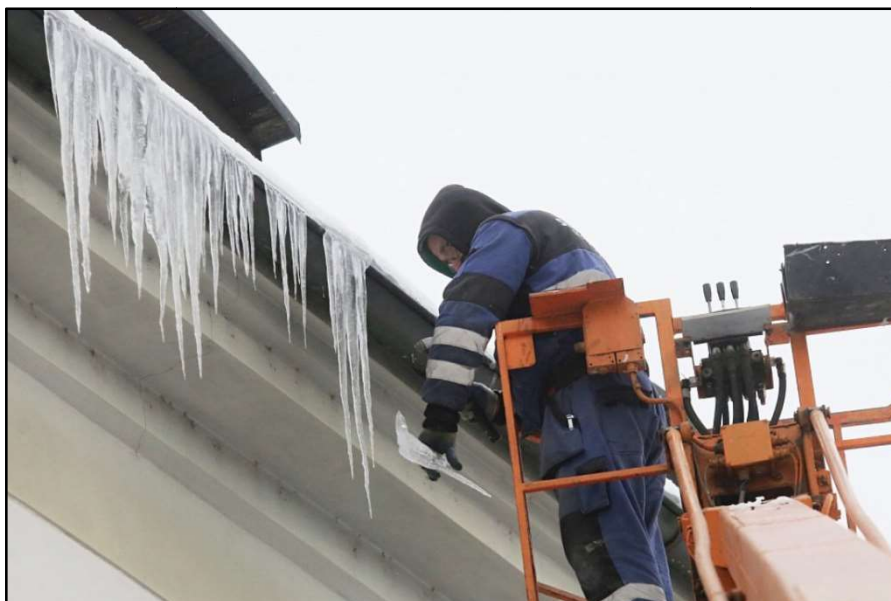
Obrázek 6 - Odborná firma v Litoměřicích s pomocí plošiny likviduje rampouchy visící ze střech
