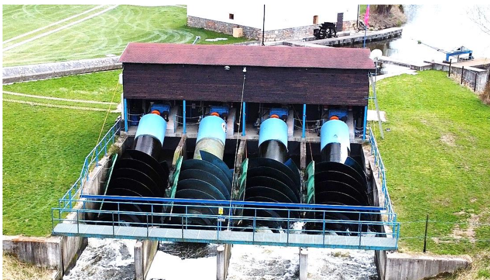
Obr. 1.14 Šnekové turbíny na MVE Kaceřov
