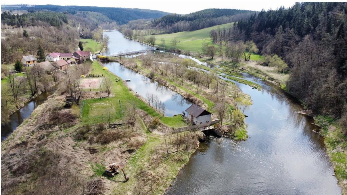
Obr. 1.4 Derivační vodní elektrárna v Olešné
