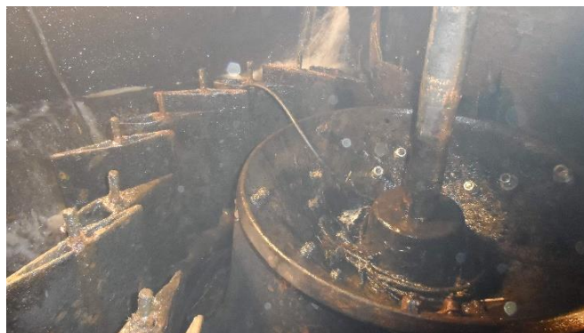
Obr. 3.7 Rozebraná turbína MVE1
