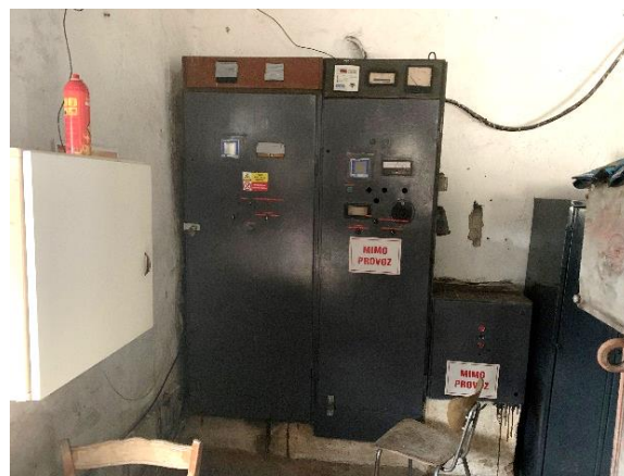
Obr. 3.3 Rozvaděče technologie MVE1+MVE2
