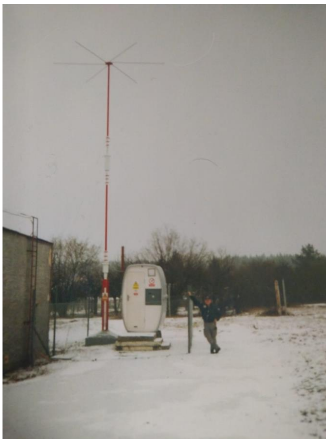
Obrázek 33 - Archivní foto nesměrového majáku instalovaného na letišti
