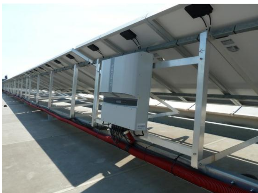
Obr. 15: Střešní instalace fotovoltaického systému v areálu Průmyslových závodů ŠKODA v Plzni o instalovaném výkonu 1,9 MWp převzato [16]
