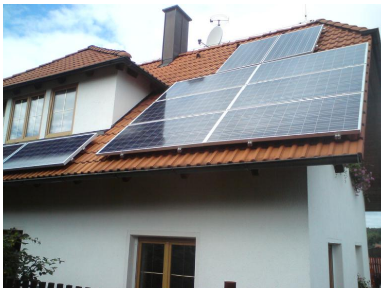
Obr. 21: Střešní instalace na rodinném domu převzato [16]
