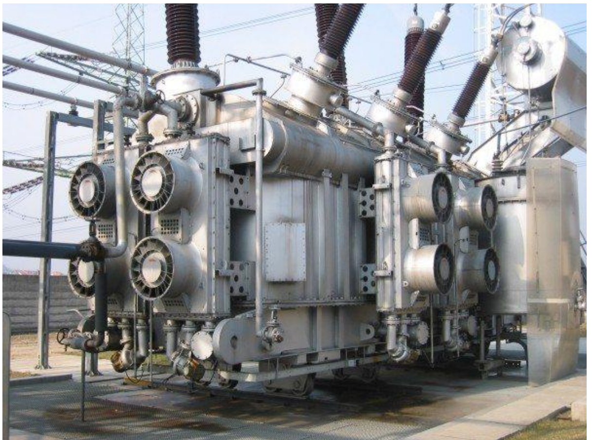
Obr. 1.1 Výkonový transformátor chlazený systémem OFAF (převzato z [10])
