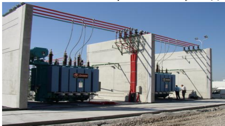
Obr. 1.2: Venkovní stání transformátoru s protipožárními zdmi [2]
