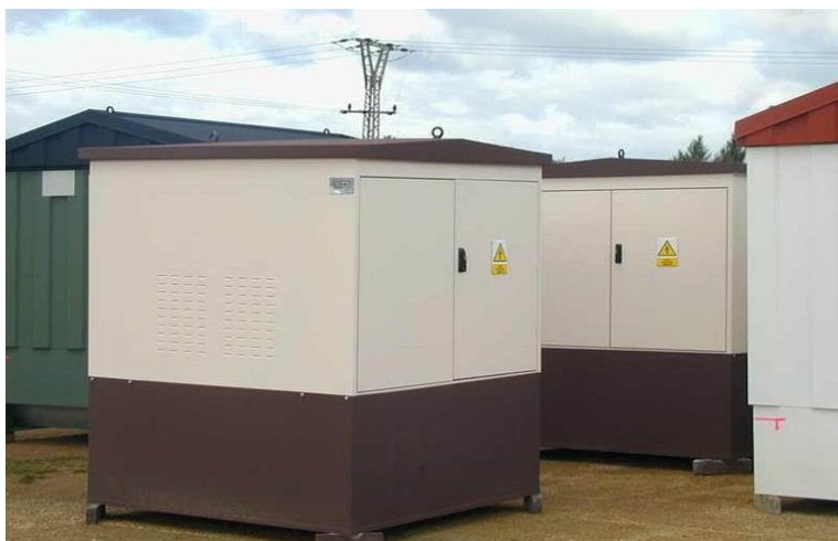
Obr. 1.1: Transformátorový kiosek s uzavřenou jímkou [2]
