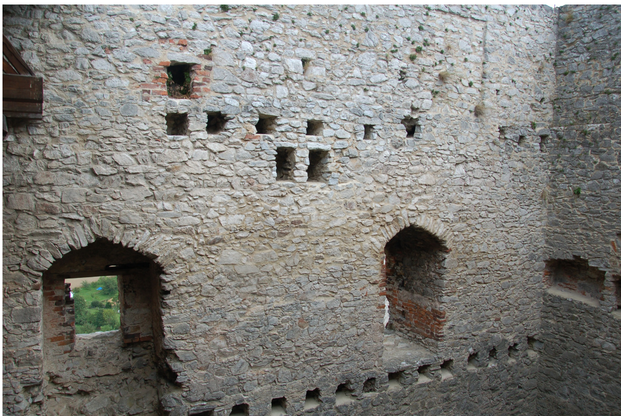
Obr. 28. Hrad Rabí (okr. Klatovy). Otvory po stropních trámech v úrovni pátého podlaží nad okny s mírně hrotitým záklenkem a sediliemi v úrovni čtvrtého podlaží. Foto autor 2017. – Abb. 28. Rabí (Bez. Klattau). Deckenbalkenlöcher im fünften Stockwerk über den Fenstern mit einem wenig gebrochenen Karnies und Sedilien im vierten Stockwerk. Foto Autor 2017.
