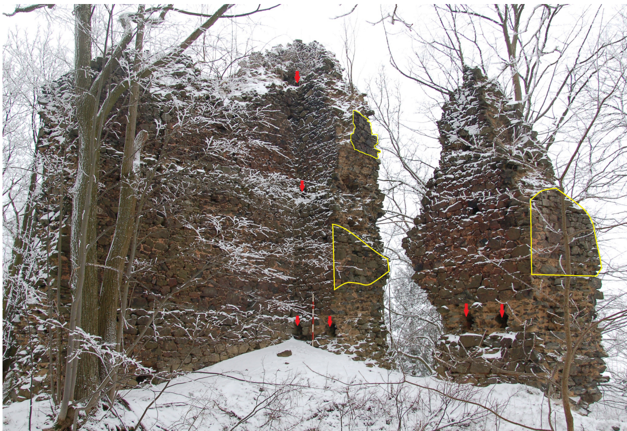
Obr. 12. Netřeb (okr. Domažlice) – Západní obvodová zeď s otvory (označeno šipkou) po osazení stropních trámů v jednotlivých podlažích. Foto a úprava autor 2017. – Abb. 12. Neu Riesenberg (Bez. Taus). Die westliche Ringmauer mit den Deckenbalkenlöchern in den einzelnen Stockwerken. Die Fensterlaibungen gelb markiert. Foto und Bearbeitung Autor 2017.
