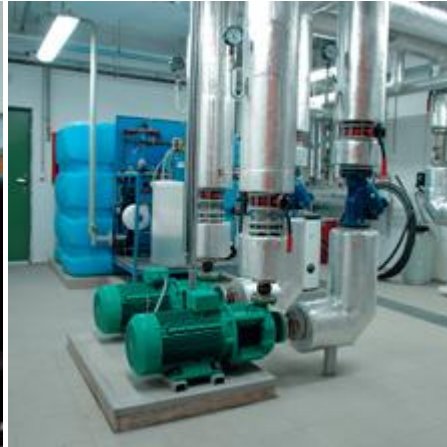
Obr. 9. Oběhová čerpadla topné vody
