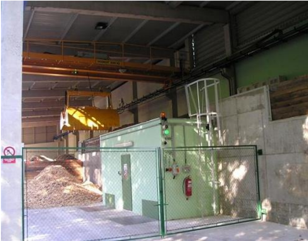
Obr. 12. Sklad paliva s mostovým jeřábem
