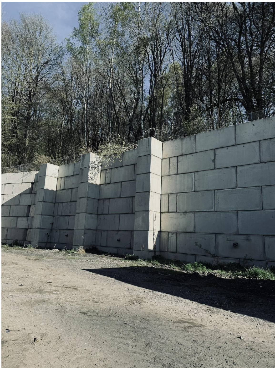
Příloha G: Fotografie úspěšně vystavěné opěrné stěny - druhá etapa projektu revitalizace sběrného dvora
