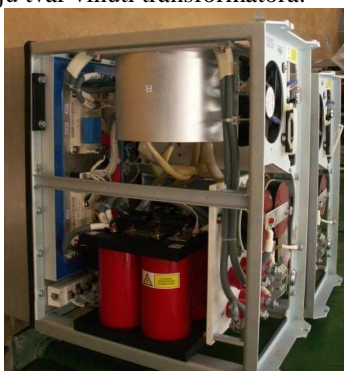
Obr. 1: Umiestnenie transformátora v skrini
