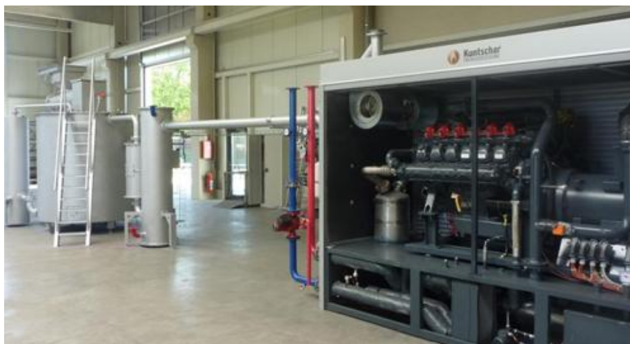
Obr. 4.3 - Zplyňovací jednotka WGPP Kuntschar , zdroj: [27]
