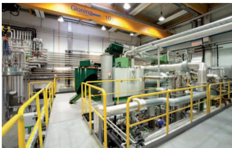
Obr. 4.4 - Zplyňovací jednotka CLEANSTGAS 250 v St. Margarethen an der Raab, zdroj: [26]
