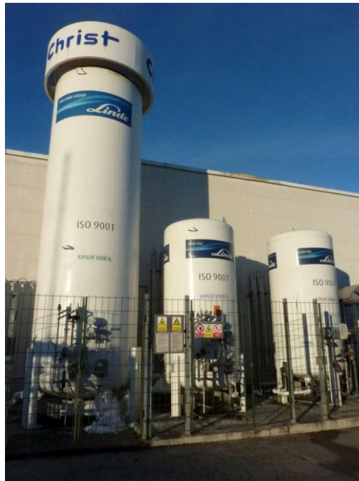
Obrázek 2-12 Ocelové tlakové nádrže
