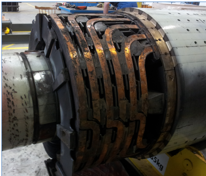
Obr. 1: Ukázka znečištění rotoru elektrického točivého stroje
