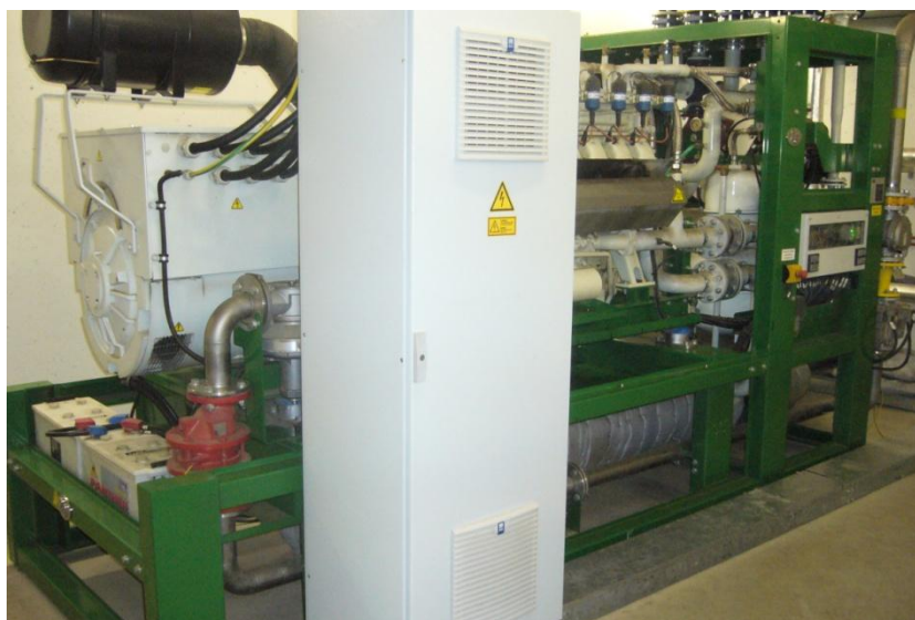
obr. 5: Kogenerační jednotka BPS Věžná
