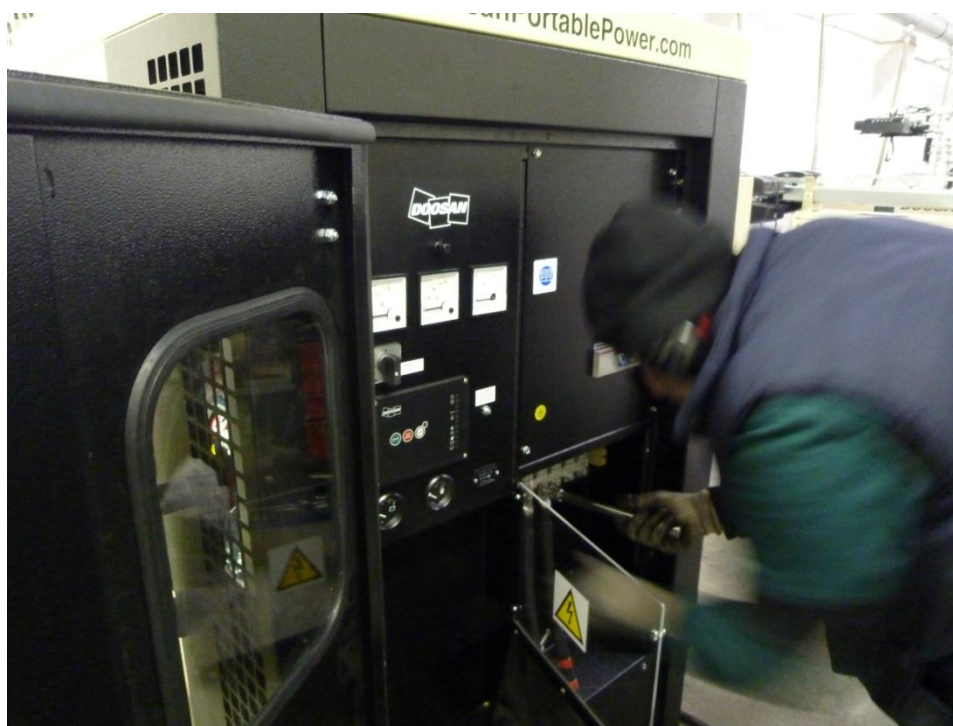
Obr.: 3.1 Práce měřícího technika u otevřené svorkovnice
