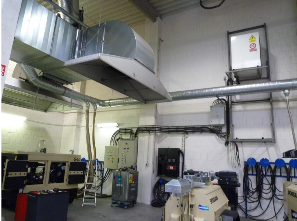
Obr. 2.1 Rozvaděče a zátěžový rezistor ve zkušební hale
