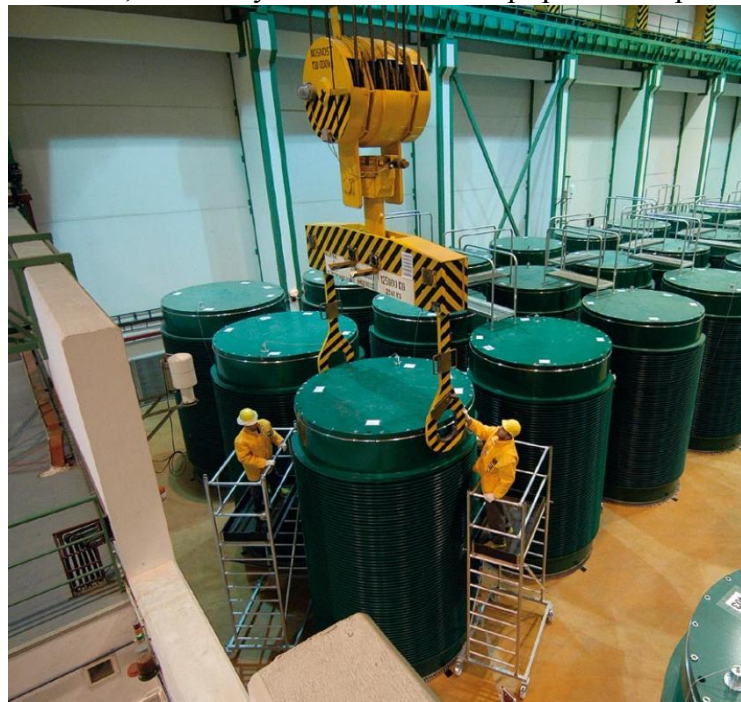
Obrázek 2.9 – Suché skladování v meziskladu vyhořelého paliva [9]
