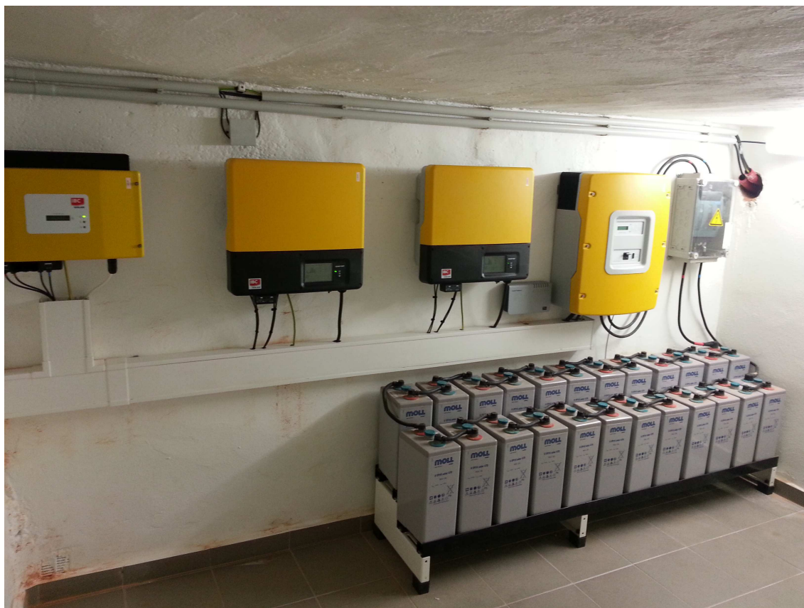
Obr. 1. 19 Technologie ostrovního systému ve sklepě domu
