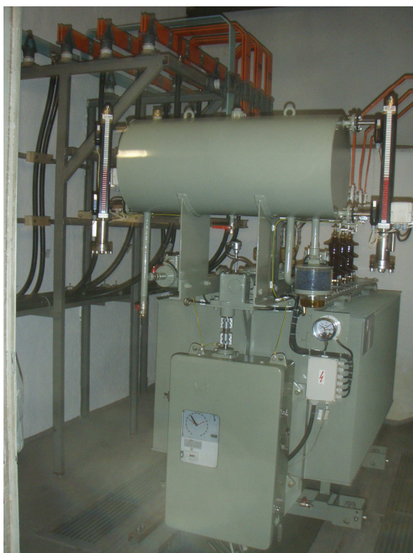
Obr. 3.3 Transformátor vlastní spotřeby EOR
