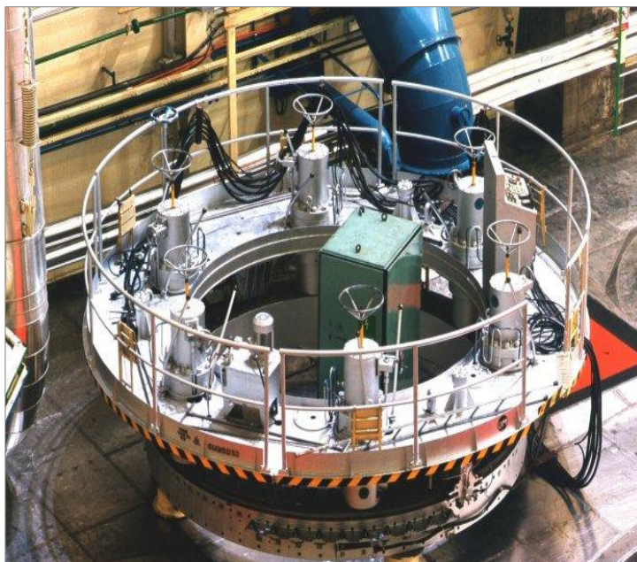
Obr. č. 14: Utahováky matic hlavního přírubového spoje – VVER 440
